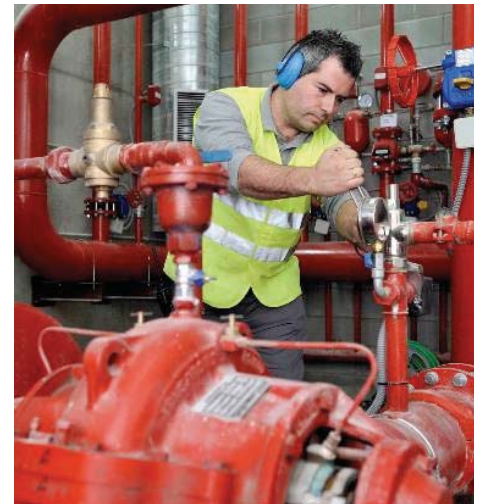
Reducciones de costes del 9,5% en contratos de mantenimiento.
